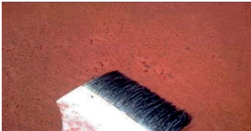
Foto A: Sistema sin Patch en pavimento poroso
